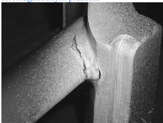
Obr. 8. Trhlina zobrazená pomocí magnetické zkoušky
